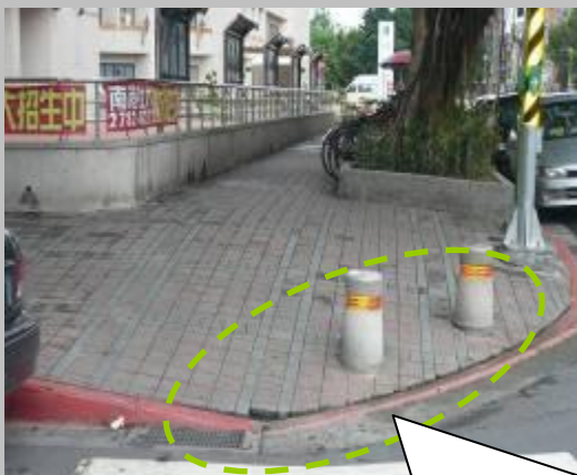
無障礙坡道有破損，導致與路面有落差
