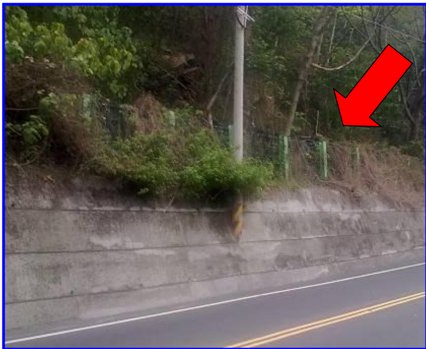
4.有防落石柵處 易坍方落石
