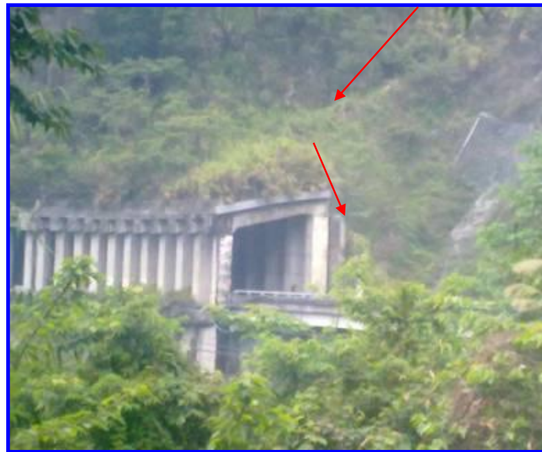
5.明隧道洞口前 後易因落石堆 滿溢流落入洞 口附近
