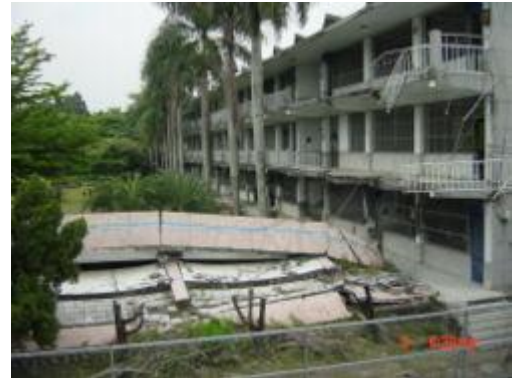
地震中遭震毀的臺中縣霧峰鄉光復國中校舍
