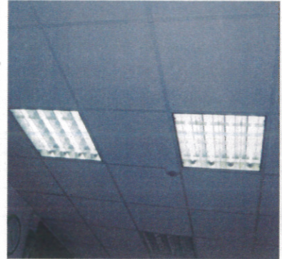
環保節能—T5 燈具、腳踏式省水閥、LED 緊急照明燈
