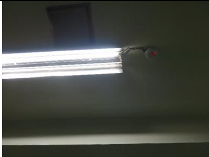
迎曦樓 4 號樓梯(1F-B1)感應照明
